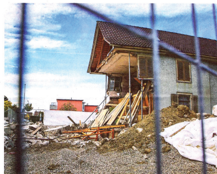
Die Mauer des Restaurants Obstgarten begrub einen Arbeiter unter sich.
